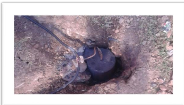
Imagen 41. Instalación de tierra física para SITE principal en Centro de Cómputo
